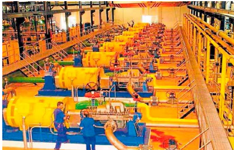
Vista del interior de la desaladora de Marbella, en una imagen de archivo. JOSELE
