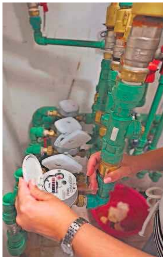
El contador de agua de un edificio salmantino. ALMEIDA
